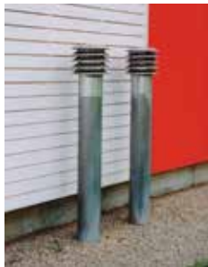
Bild 4-35: Gut platzierte Aussenluftfassung
