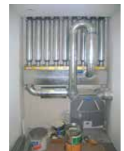
Bild 4-38 Gerät im Abstellraum eines Mehrfamilienhauses (Zurfluh Lottenbach)
