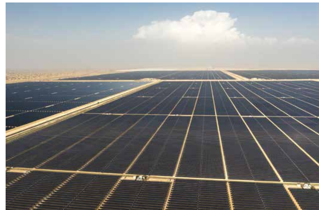
Figure 2.3: Les grandes installations sont souvent construites avec des Power Purchase Agreements (PPA) faisant l'objet d'un appel d'offres concurrentiel. (Photo: kertu_ee via iStock)
